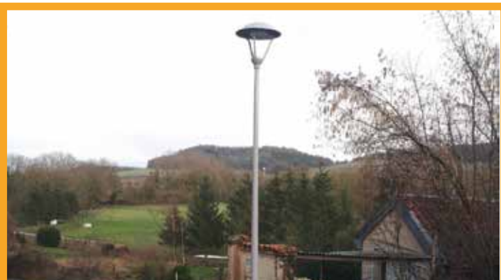
Programme d'éclairage public secteur Damvillers - 3ème année
